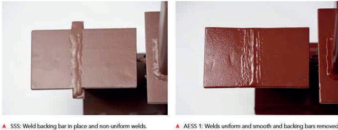
Figura 34. Izquierda: soldadura no uniforme hecha en sitio y derecha: soldadura uniforme (categoría 1 de acuerdo con AESS)
